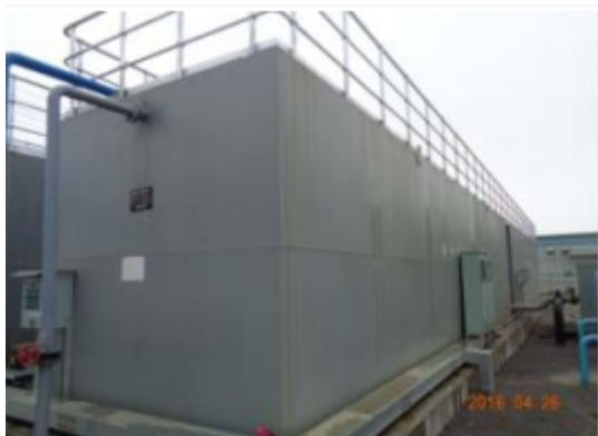
生活污水处理站
