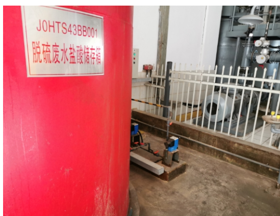
脱硫系统酸储罐
